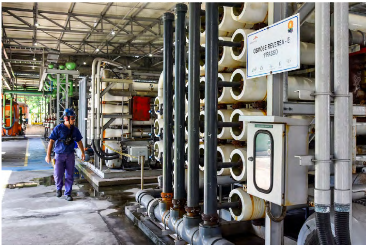
FIGURA 13 – Equipamento da Usina de Dessalinização da ArcelorMittal Tubarão
