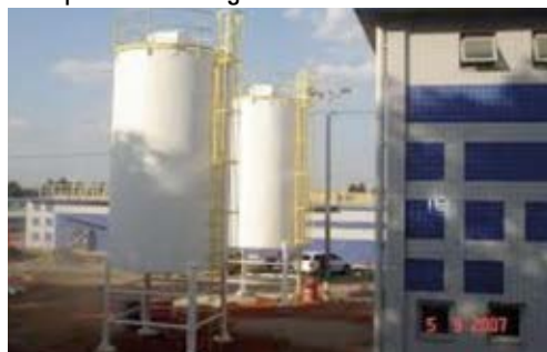
FIGURA 10.2 Tanque de estocagem de Hidróxido de Cálcio
