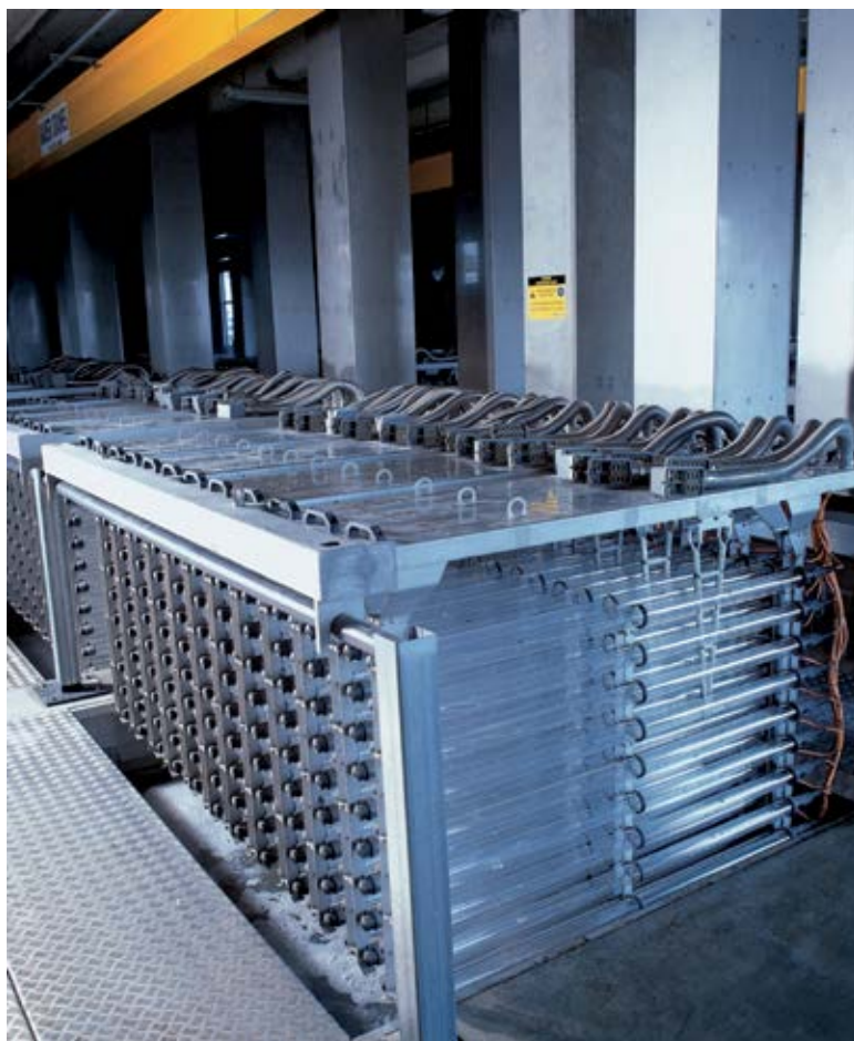
FIGURA 16.2 Unidade de ultravioleta
