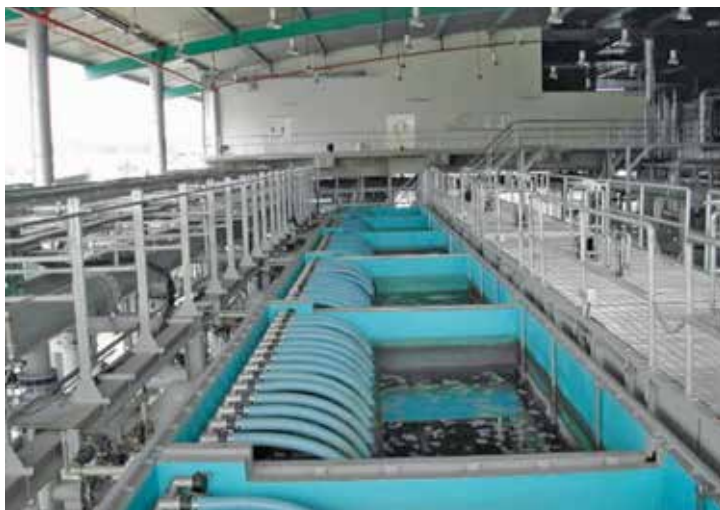
FIGURA 14.4 Unidade de microfiltração
