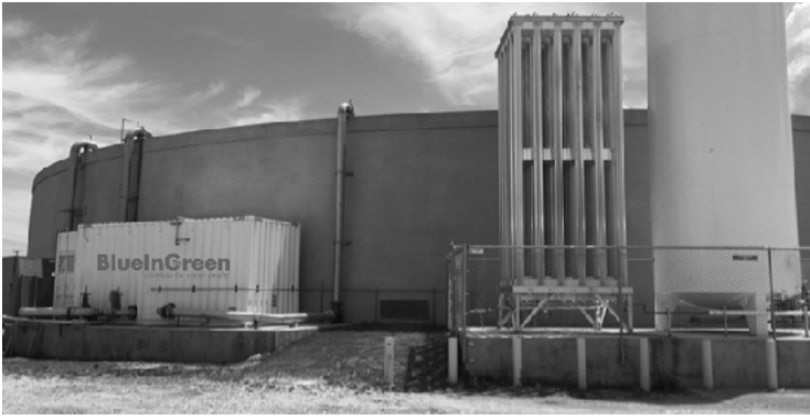
FIGURA 1: Aumente a capacidade sem interromper as operações O processo de dissolução de fluxo lateral da solução SDOX® permitiu que a Mountaire Farms adaptasse uma capacidade de tratamento significativa nas bacias de tratamento que estavam sobrecarregadas sem interromper as operações. O processo de fluxo lateral atrai o afluente para cima e sobre a parede da bacia para o sistema SDOX e, em seguida, retorna a solução supersaturada de volta à bacia.
