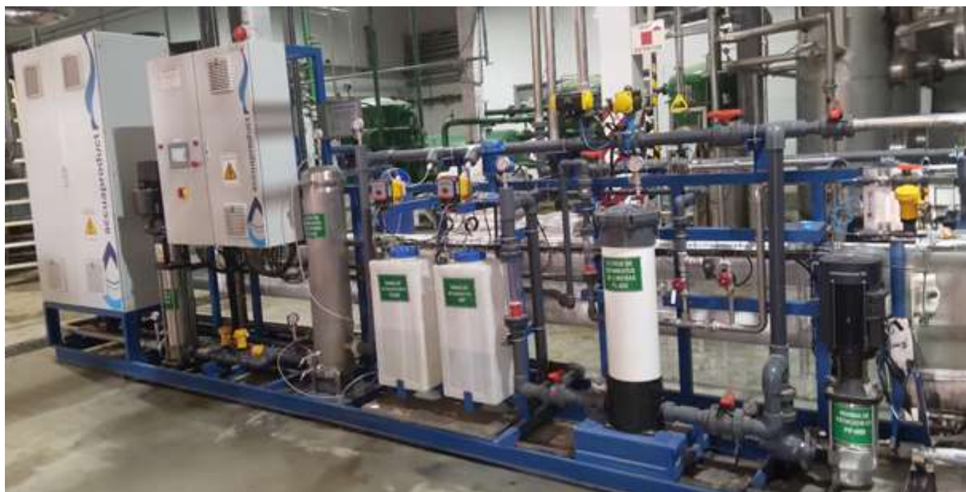
Detalle de la avanzada infraestructura de la planta de tratamiento terciario de Accuaproduct en Santa Cruz, contribuyendo a la sostenibilidad del agua en la región
