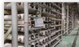
Reuso de Efluentes: 90,000m 3 /d
