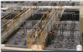
ETE Municipal : 15,000m 3 /d
