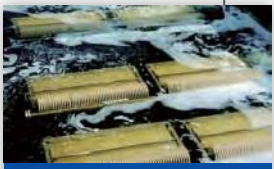
ETE Municipal : 3,500m 3 /d
