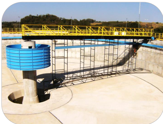
RASPADOR DE FUNDO ( ACIONAMENTO PERIFÉRICO )
