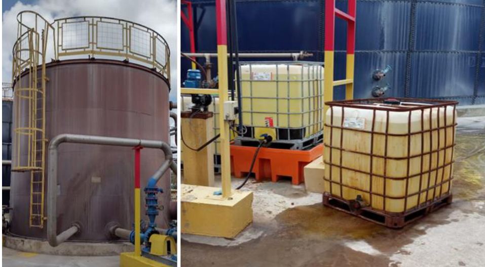
Figura 19 – Tanque de condicionamento e dosagem de ácido.
