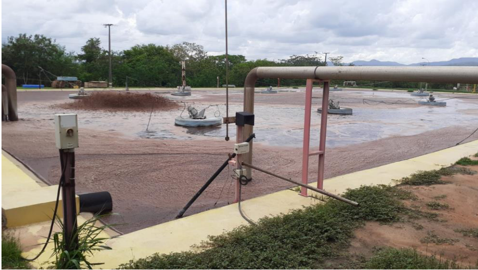
Figura 23 – Lagoa de aeração.
