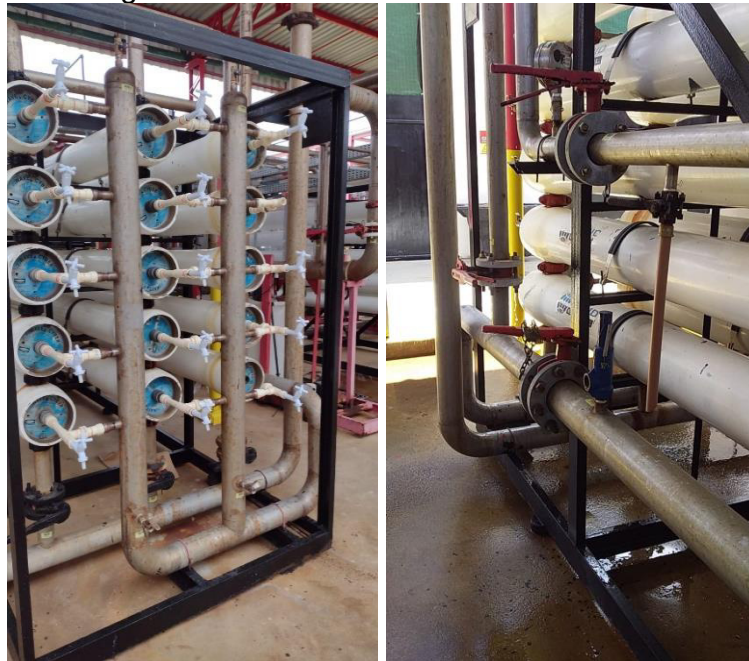
Figura 11 – Banco de osmose reversa 1.
