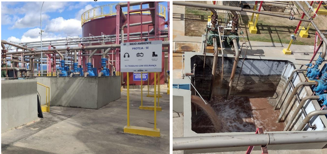
Figura 17 - Elevatória de entrada ETEI
