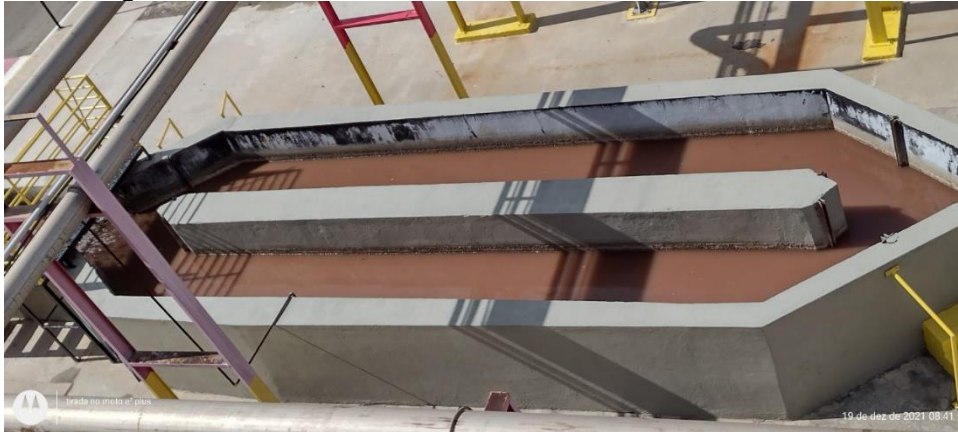
Figura 16 – Caixa de areia do recebimento de efluente.
