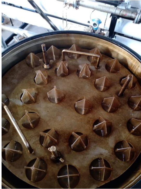
Figura 14 – Filtro polidor do sistema de osmose reversa 2.
