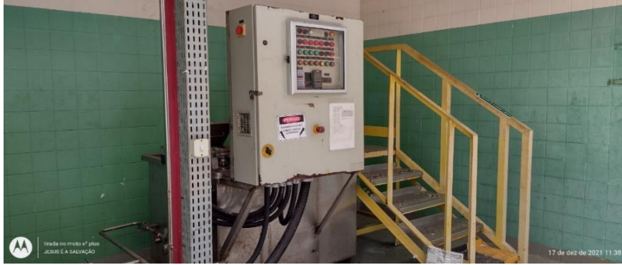
Figura 5 – Equipamento de dosagem de polímero da ETA.
