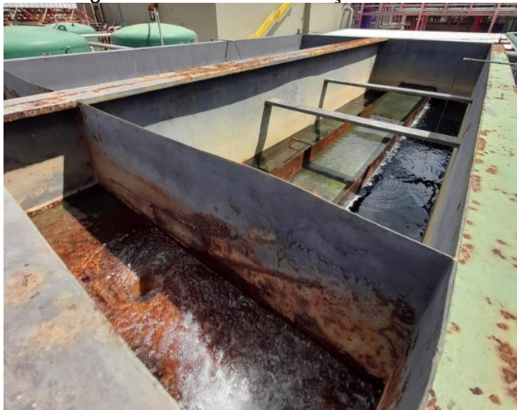
Figura 9 - Câmara de filtração da ETA.
