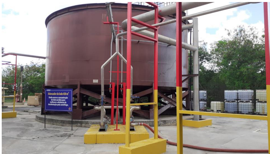
Figura 25 – Adensador de lodo.
