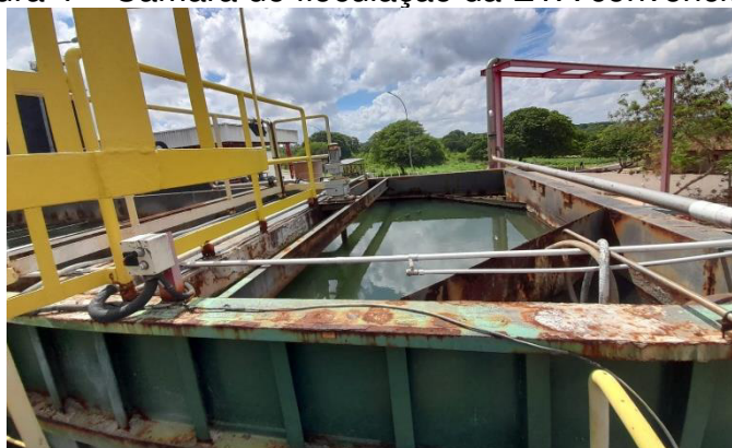
Figura 4 – Câmara de floculação da ETA convencional.
