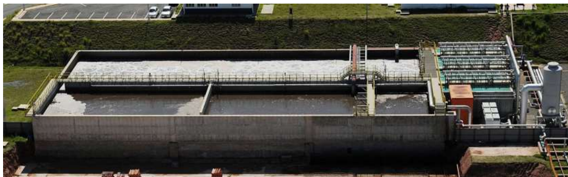
Figura 09. Sistema Biológico da Estação de Tratamento
