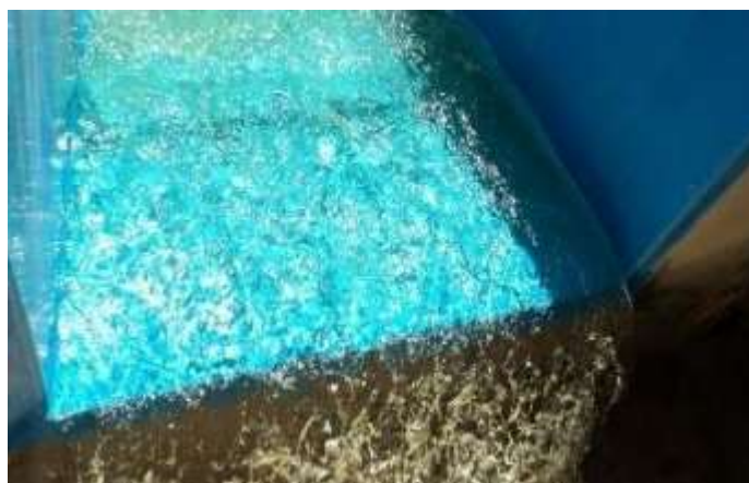
Figura 12. Efluente tratado saindo pela calha Parshall
