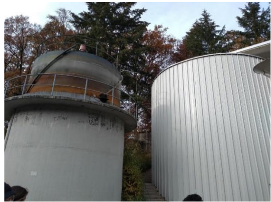
Figura 11: Biodigestor que recebe os lodos provenientes dos sistemas de tratamento da ETE do ISWA.
