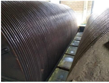
Figura 8: Reator Biológico de Disco Rotatório em operação na ETE do ISWA.
