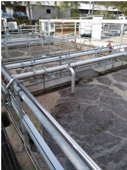
Figura 6: Sistema de Lodos Ativados em operação na ETE do ISWA.
