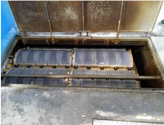
Figura 10: Sistema de Filtração por Micro peneira instalado na ETE do ISWA.
