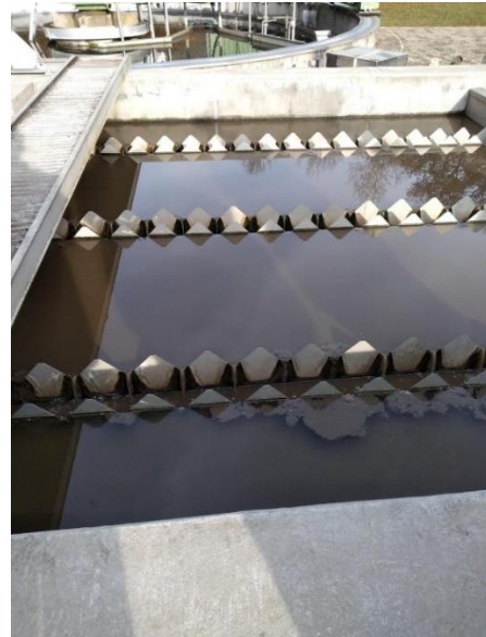
Figura 7: Sistema de separação do lodo instalado na ETE do ISWA.
