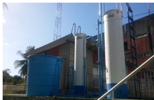
(d) filtro de fluxo ascendente (FFA), filtro de fluxo descendente (FFD) e o reservatório de água tratada (RAT).
