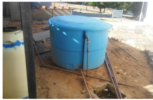
(b) reservatório de água bruta (RAB);
