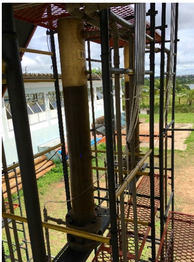
Figura 3.7 - Vista do Filtro ascendente de pedregulho (FAP).
