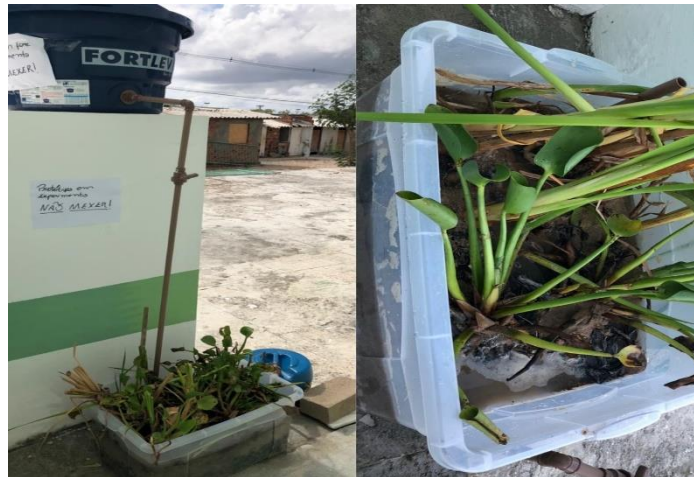
Figura 2: Tratamento de água residual de Águas Cinzas via Wetlands Construídos.
