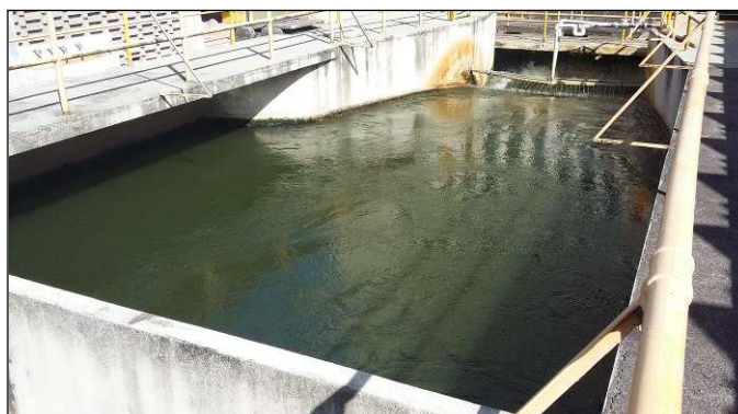
Figura 1: Entrada de água bruta na ETA Castello Branco.
