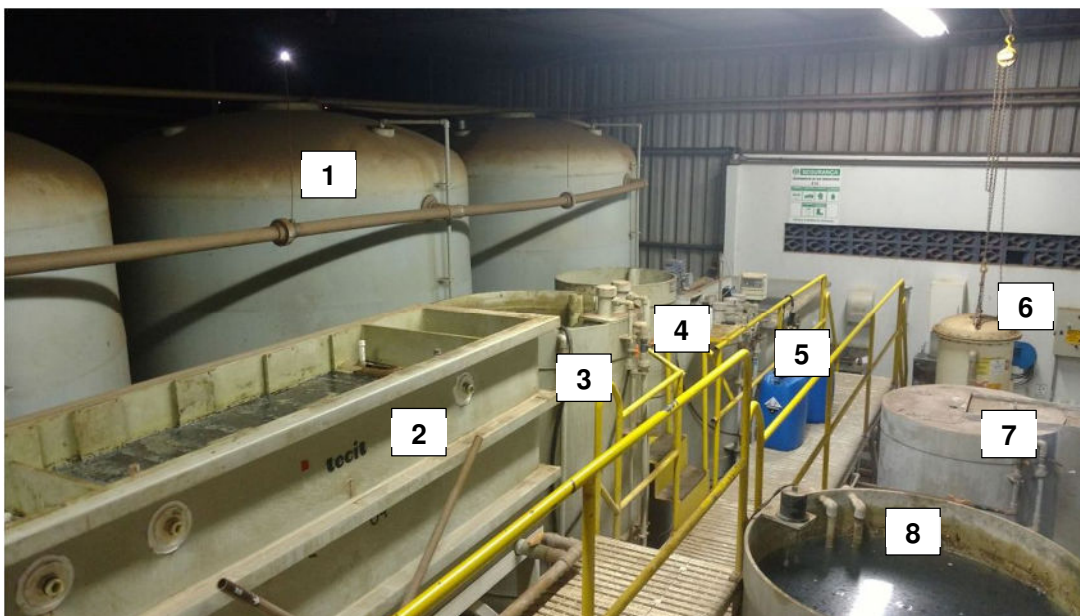
Figura 6 – Unidade de tratamento de efluentes em estudo.
