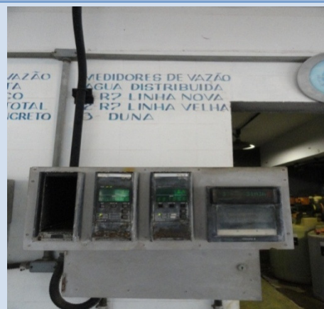
Figura 109 - Vista do macromedidor de água tratada localizado na ETA Teodoro Sampaio. Salvador, junho de 2011.
