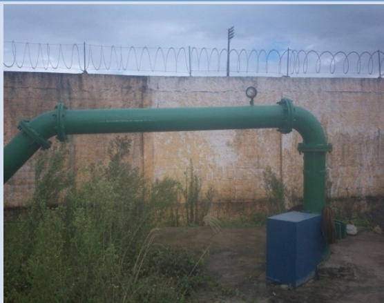
Figura 96 - Vista do barrilete do Poço 6 (Espaço Alpha 2). Camaçari, junho de 2011.
