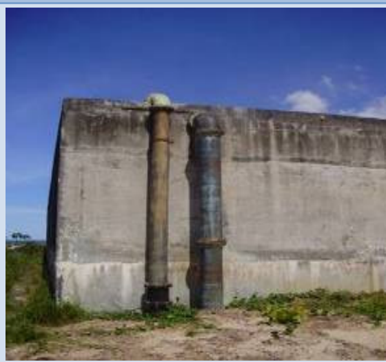
Figura 105 - Chegada das adutoras da EEAT e Poço 07 no RAD 6.000 m 3 . Camaçari, junho de 2011.
