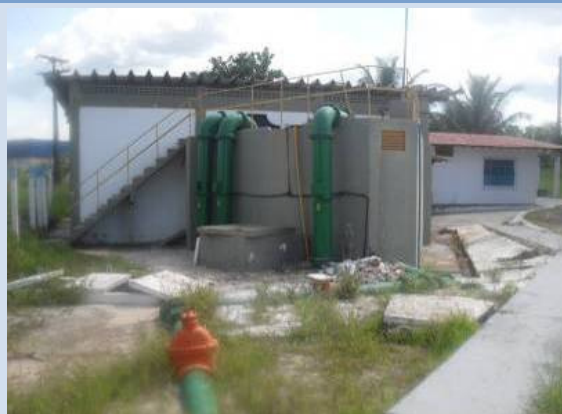
Figura 101 - Vista da caixa de reunião dos Poços 1 a 5 (Espaço Alpha). Camaçari, junho de 2011.
