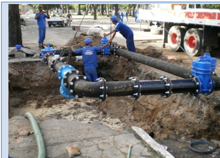
Figura 35 - Montagem de estrutura de controle de pressão na Avenida Luiz Tarquínio (Largo de Roma). Salvador, fevereiro de 2011.
