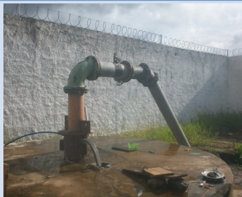
Figura 99 - Vista do barrilete do Poço 7 (Morro da Manteiga) com vazamento no barrilete. Camaçari, junho de 2011.
