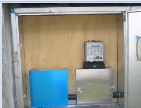
Figura 113 - Vista do medidor de energia do Poço 7 (Morro da Manteiga). Camaçari, junho de 2011.
