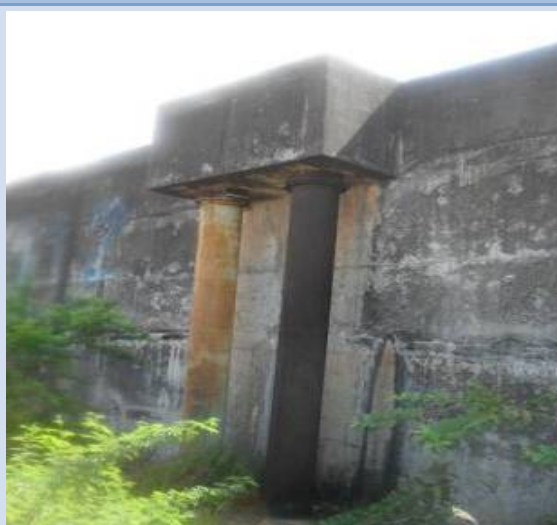
Figura 104 - Vista dos extravasores do RAD de 6.000m 3 . Em detalhe vazamento na estrutura do reservatório. Camaçari, junho de 2011.
