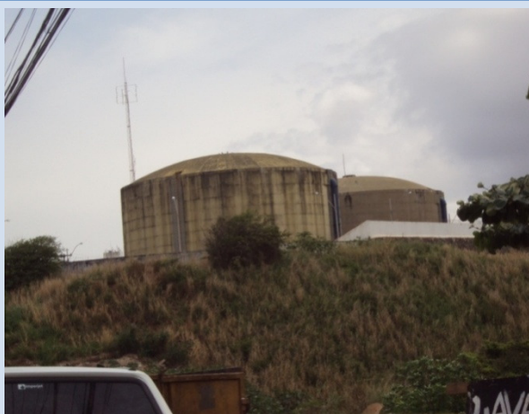
Figura 110 - Vista das duas câmaras do reservatório de distribuição R1 Duna. No alto detalhe da antena de transmissão dos dados para central de operação (automação). Salvador, junho de 2011.
