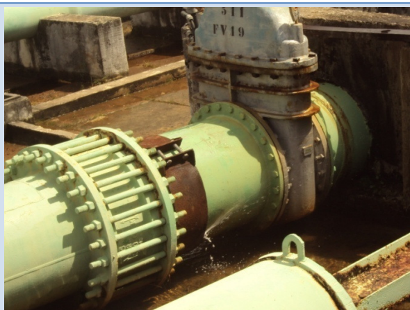
Figura 106 - Saída da linha de recalque para o R1 Duna. Detalhe do vazamento na junta do barrilete. Salvador, junho de 2011.
