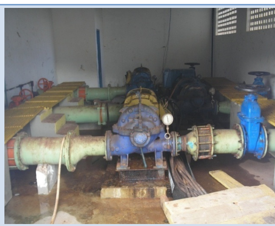
Figura 119 - Vista interna da estação elevatória. Camaçari, junho de 2011.
