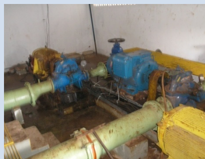
Figura 121 - Vista dos CMB instalados na posição 2 e 3, com detalhe para os vazamentos e cabos expostos. Camaçari, junho de 2011.
