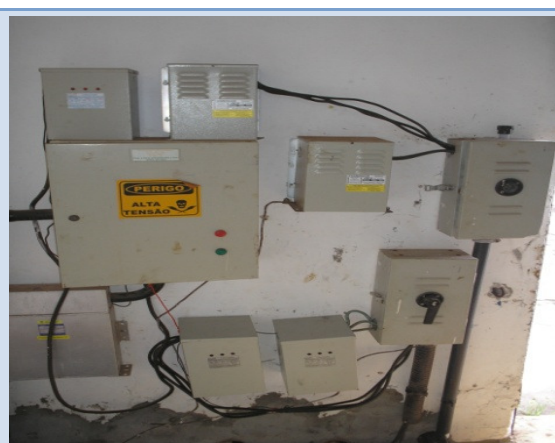
Figura 117 - Vista dos diversos módulos de bancos capacitores instalados na EEAT Espaço Alpha com alguns módulos encontrando-se fora de operação. Camaçari, junho de 2011.
