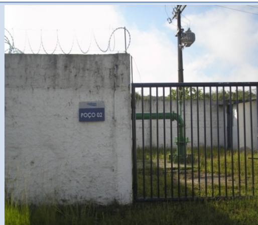
Figura 95 - Poço 02 – Vista do barrilete de recalque com área devidamente cercada e protegida. Camaçari, junho de 2011.
