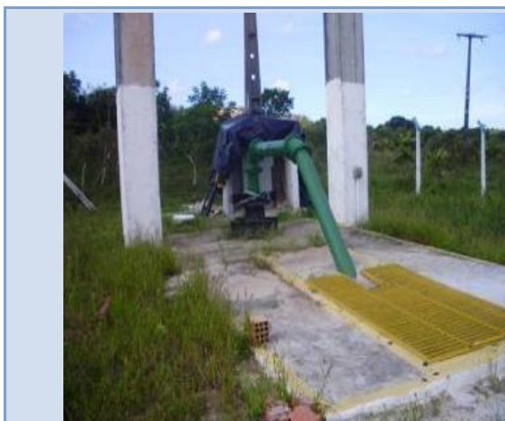
Figura 94 - Poço 01 – Vista do barrilete sem presença de macromedidor de água bruta. Camaçari, junho de 2011.
