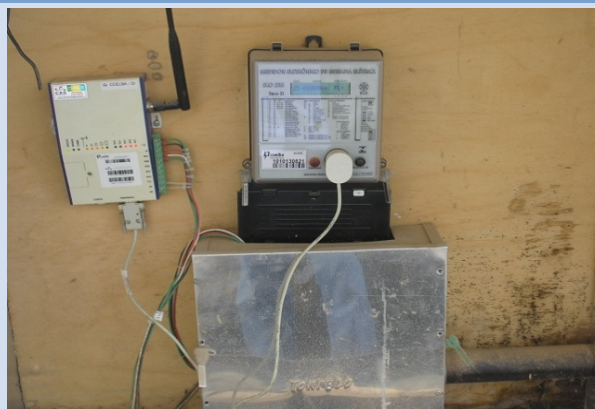
Figura 114 - Vista do medidor de energia do Poço 6 (Espaço Alpha 2) – Detalhe para o modem com antena transmissora. Camaçari, junho de 2011.
