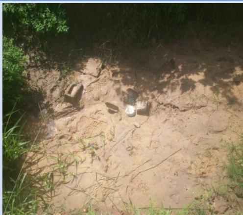
Figura 97 - Vista do macromedidor do Poço 6 (Espaço Alpha 2) totalmente encoberto por areia. Camaçari, junho de 2011.
