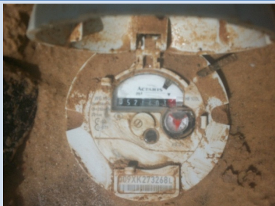
Figura 98 - Vista do macromedidor do Poço 6 (Espaço Alpha 2) em funcionamento totalmente encoberto por areia. Camaçari, junho de 2011.
