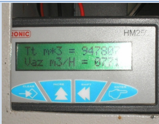
Figura 102 - Vista do macromedidor de saída da EEAT. Camaçari, junho de 2011.
