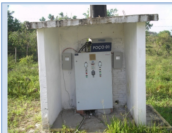
Figura 116 - Módulos de bancos capacitores instalados ao lado do painel elétrico (um de cada lado) do Poço 1 Espaço Alpha. Camaçari, junho de 2011.
