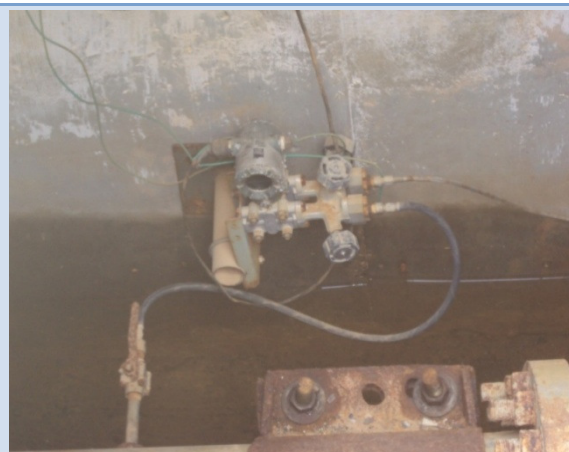
Figura 107 - Detalhe do macromedidor tipo pitot capacitivo instalado na linha de recalque. Salvador, junho de 2011.
