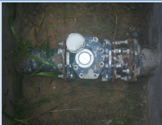
Figura 100 - Vista do macromedidor do Poço 7 (Morro da Manteiga) em funcionamento instalado dentro de caixa de proteção. Camaçari, junho de 2011.
