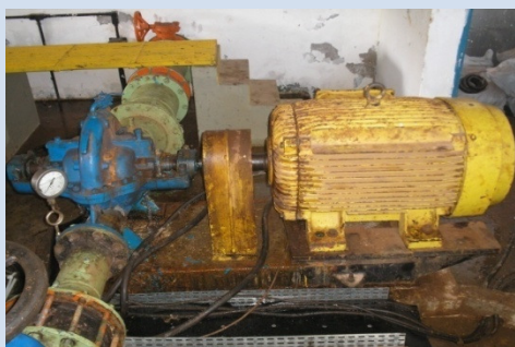
Figura 120 - Vista do CMB instalado na posição 1, com detalhe para os vazamentos e cabos expostos. Camaçari, junho de 2011.
