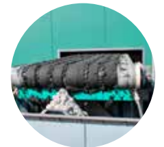
Desaguamento de estruvita
