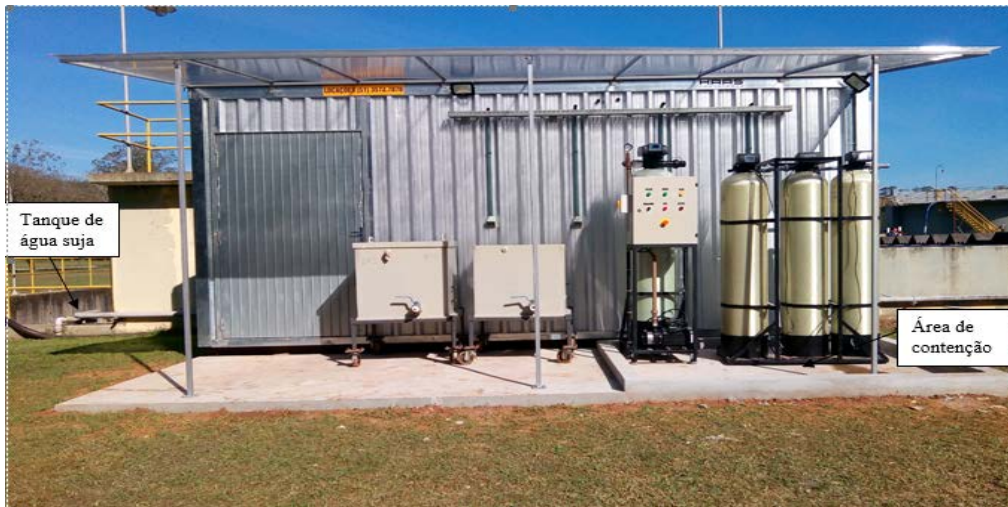
Figura 3: Unidade Piloto de Reuso de Efluente Petroquímico.
