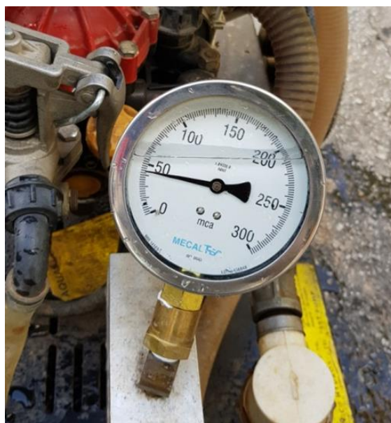
Figura 3: Registro da pressão de trabalho da rede
