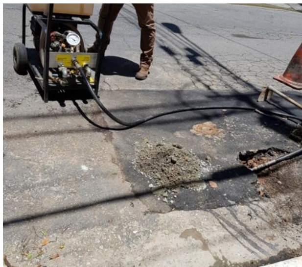
Figura 2: Ponto de instalação.
