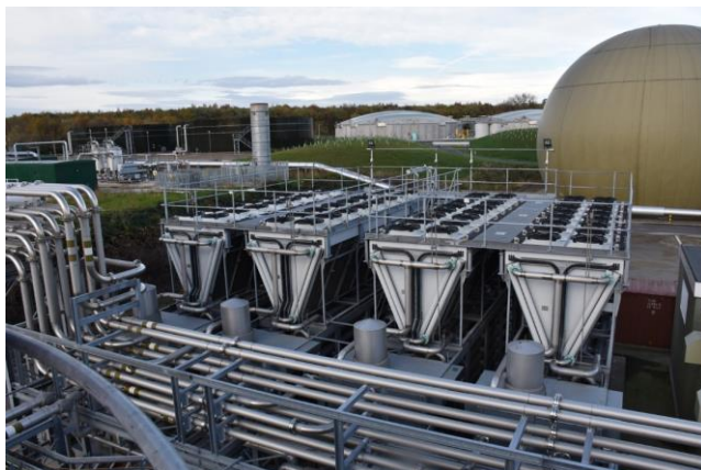
Figura 20: Trocadores de Calor para resfriamento do lodo processado em Full Cambi na ETE de Davyholme operada pela United Utilities
