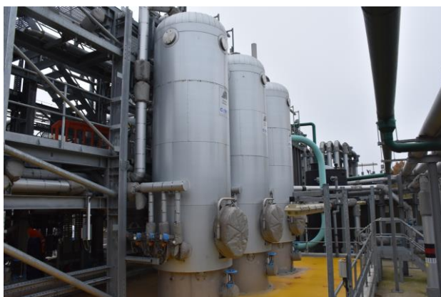
Figura 3: Reatores de Hidrólise Térmica dedicada a descarte de lodo ativado da ETE de Long Reach – Thames Water
