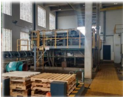
Figura 7 - Unidade de Desaguamento.
