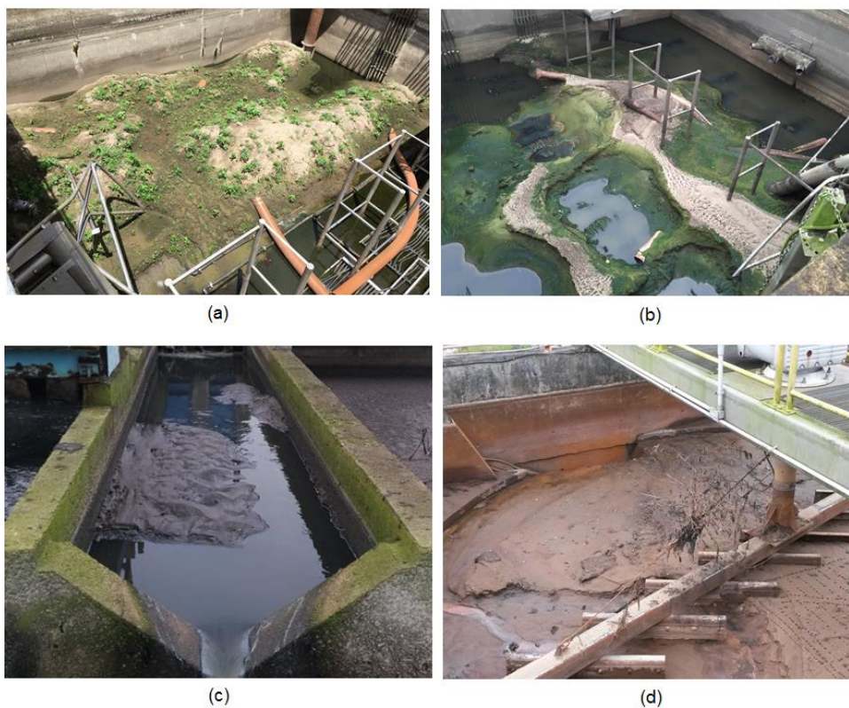
Figura 7: Areia acumulada nas unidades das ETEs da Baixada Santista. Fonte: Consórcio Engecorps-SHS, 2018.
