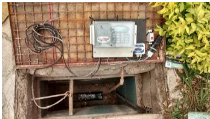
Figura 1: Vista superior do sistema: ponto de medição e amostragem composto pela calha tipo Palmer e Bowlus com transmissor e indicador de vazão por ultrassom e o Data-Logger
