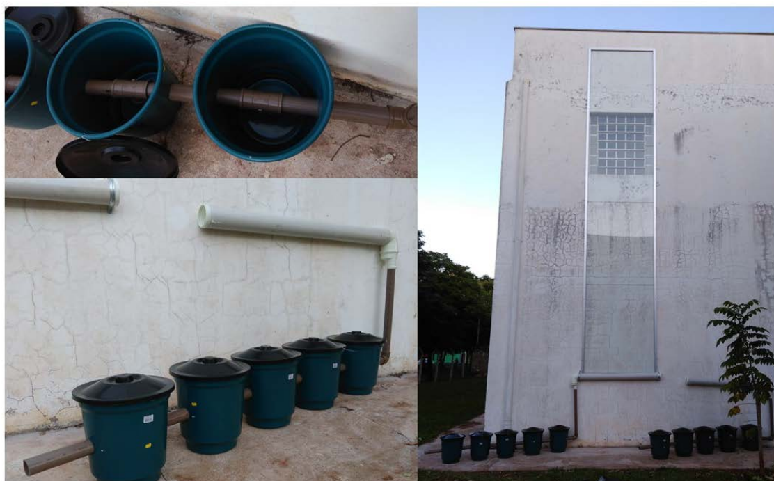
Figura 3: Equipamentos de coleta e separação da água da chuva escoada das paredes
