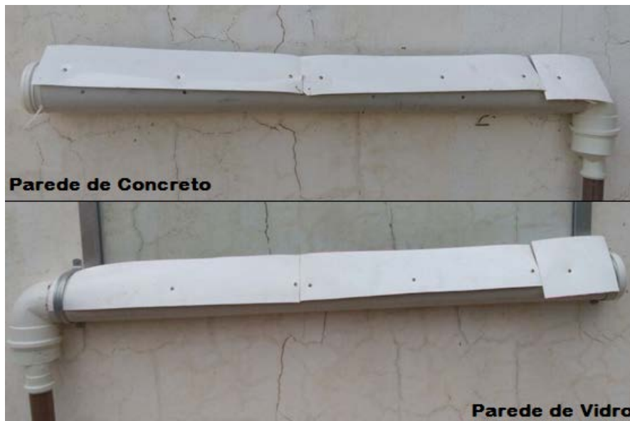
Figura 2: Calhas instaladas para a coleta da água da chuva das paredes
