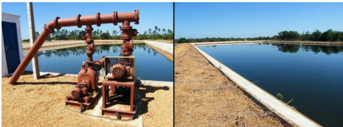
Figura 05: Lagoa de maturação e recalque do efluente tratado da ETE Aurenly
