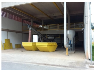
Foto 08: Sistema de Desidratação
