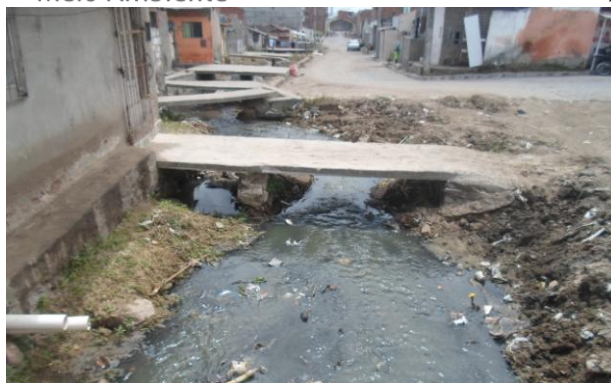
Figura 4: Presença de esgoto a céu aberto
