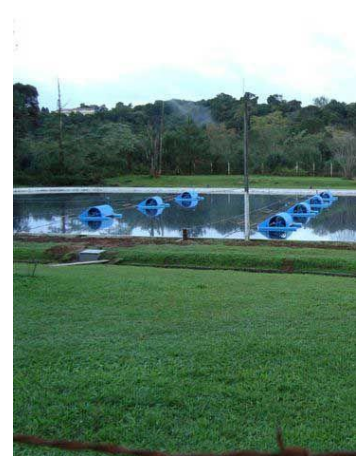
Figura 6 Aeradores na ETE São Lourenço
