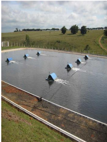
Figura 4: Aeradores em ETE Queiroz
