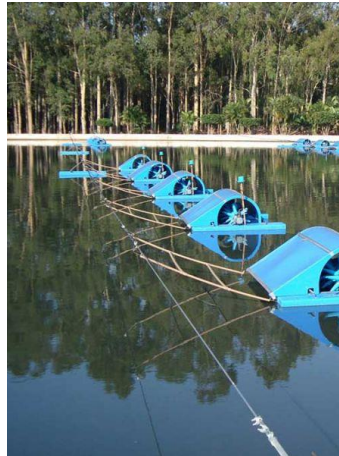
Figura 5: Aeradores na ETE Lucélia
