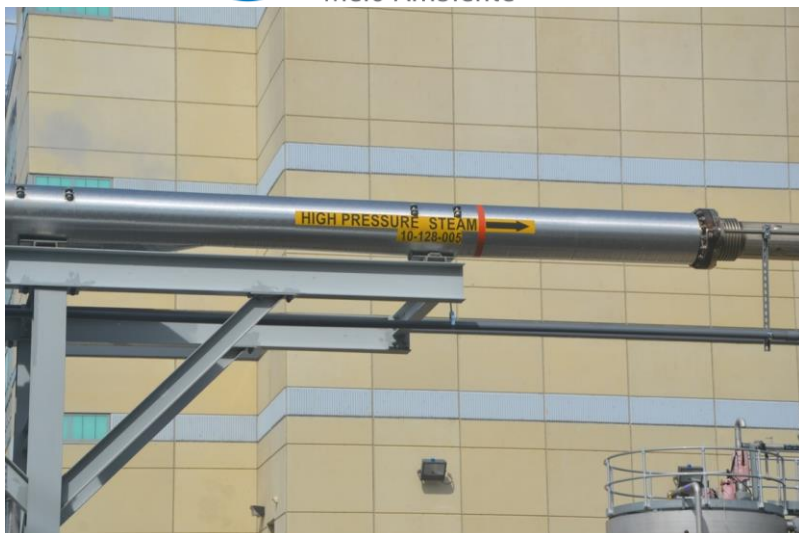
Figura 3.7: Tubulação de vapor a alta pressão na Planta Blue Plains da DC Water
