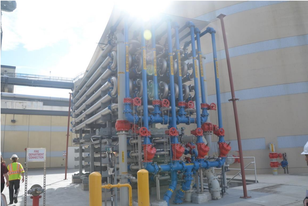
Figura 3.5: Trocadores de calor na Planta Blue Plains da DC Water
