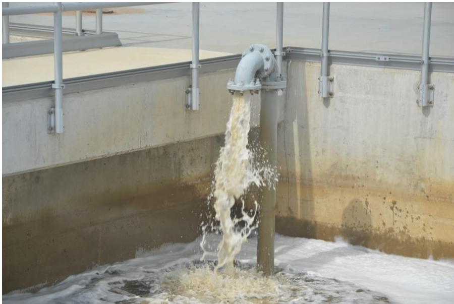
Figura 3.11: Entrada de centrado do Filtro Prensa de Esteira para o Reator DEMON da Planta Blue Plains da DC Water
