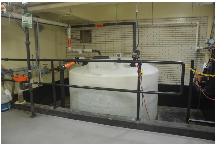
Figura 4.7: Reservatório de Soda Cáustica, NaOH (50%) para o Reator Pondus da Planta de Kenosha
