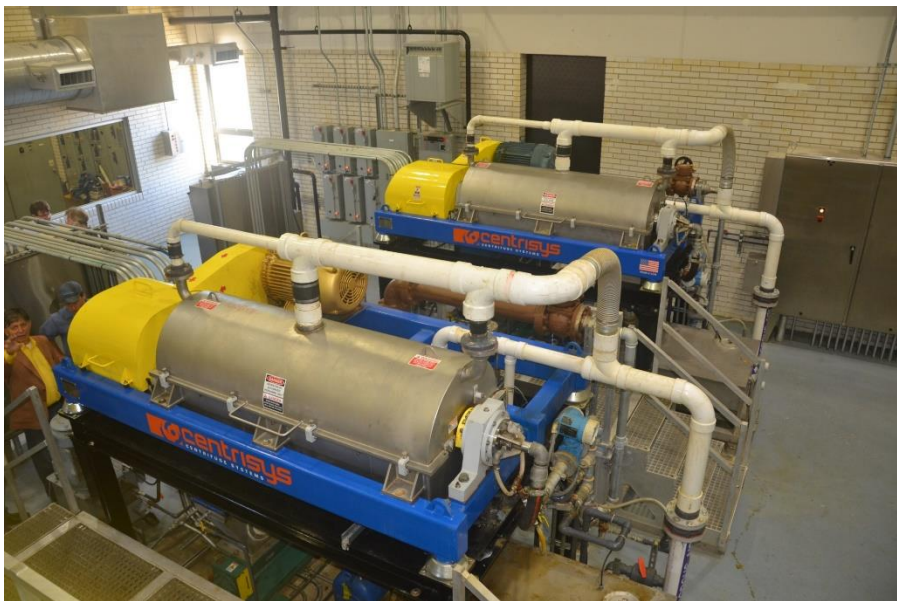
Figura 4.3: Centrífugas THK para adensamento do Lodo Primário e Secundário da Planta de Kenosha
