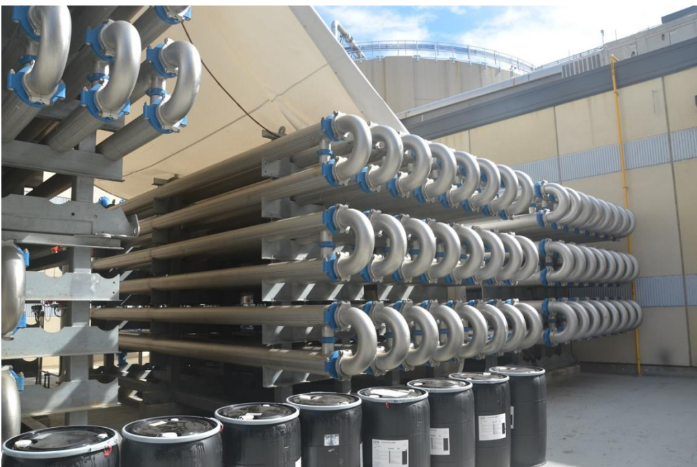
Figura 3.6: Trocadores de calor na Planta Blue Plains da DC Water
