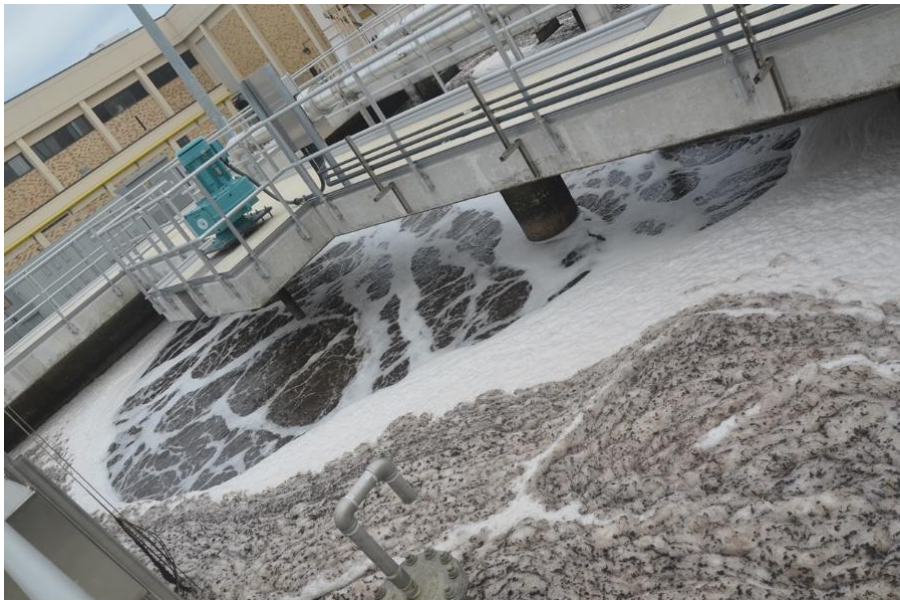
Figura 3.12: Reator DEMON (tipo batelada) da Planta Blue Plains da DC Water com sistema de aeração da Invent
