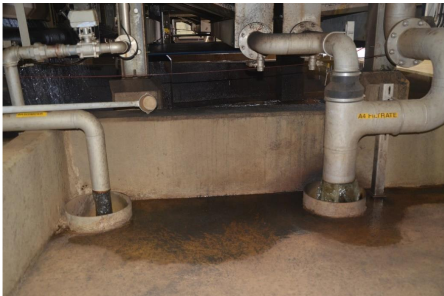
Figura 3.9: Tubulações de água de lavagem e filtrado dos Filtros Prensa de Esteira para Desidratação do Lodo da Planta Blue Plains da DC Water
