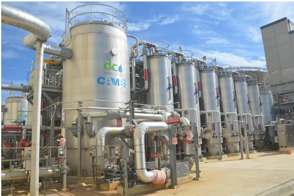
Figura 3.3: Reatores Cambi na Planta Blue Plains da DC Water
