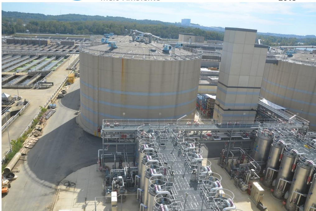
Figura 3.4: Vista geral dos Digestores Anaeróbios Mesofílicos e Reatores Cambi na Planta Blue Plains da DC Water
