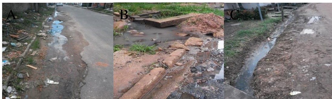
Figura 11: Identificação de problemas no meio fio
