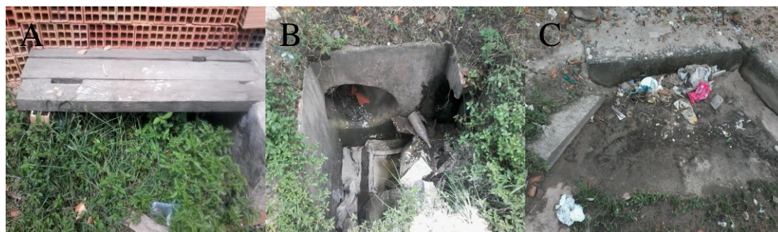
Figura 12: Identificação de problemas nas bocas de lobo
