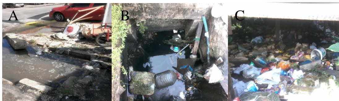
Figura 15: A) Boca de lobo entupida; B) e C) Resíduos no interior das bocas de lobo
