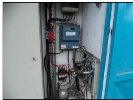
Figura 5 – Instalações em Monolito.
