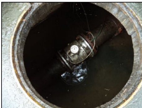
Figura 4 - Macromedidor Primário vistoriado.
