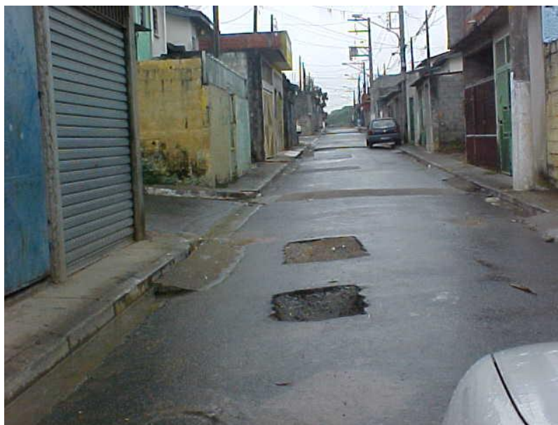
Figura 04– Recorrências de Vazamentos observados
