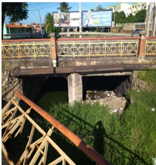
Figura 03: Imagem do acúmulo de lixo, despejo de esgotos clandestinos e assoreamento da lagoa.
