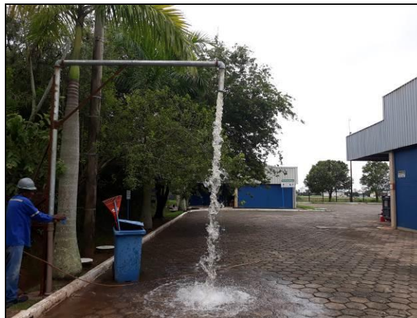
Figura 7. Tomada para abastecimento de caminhões na ETE Aeroporto.
