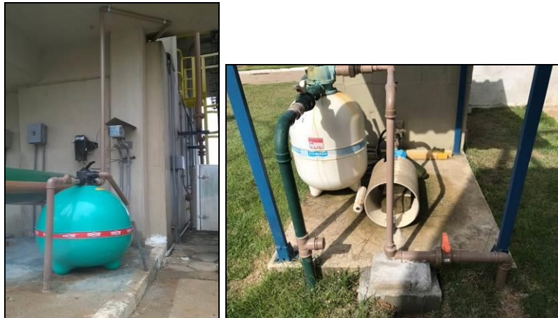
Figura 6. Filtros de areia instalados nas ETEs Aeroporto e Centro.
