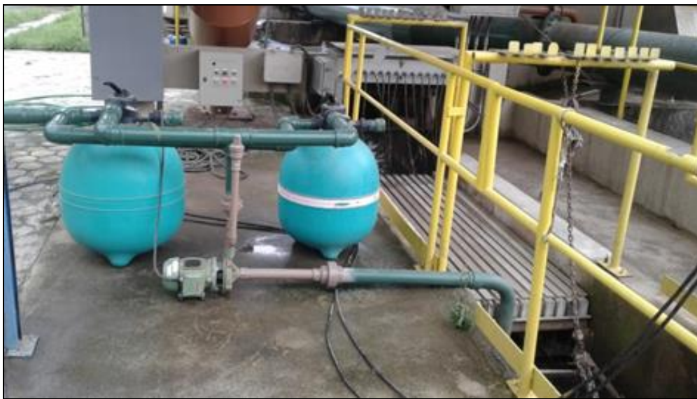
Figura 2. Sistema de polimento de efluente da ETE Bandeirantes.
