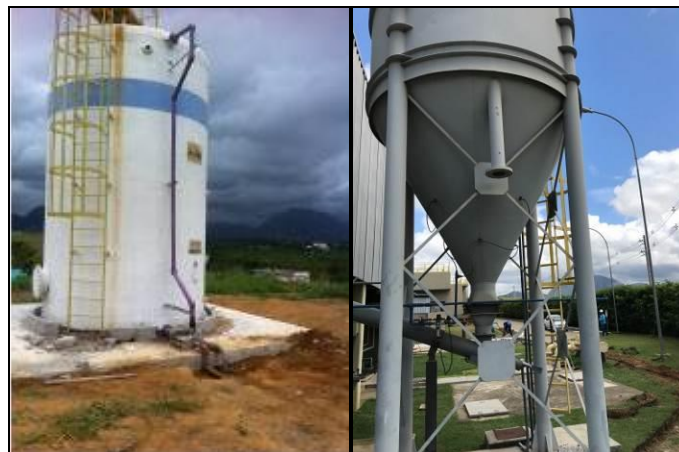
Figura 5. Reservatórios ETE Centro – capacidade total de 60 m 3 .
