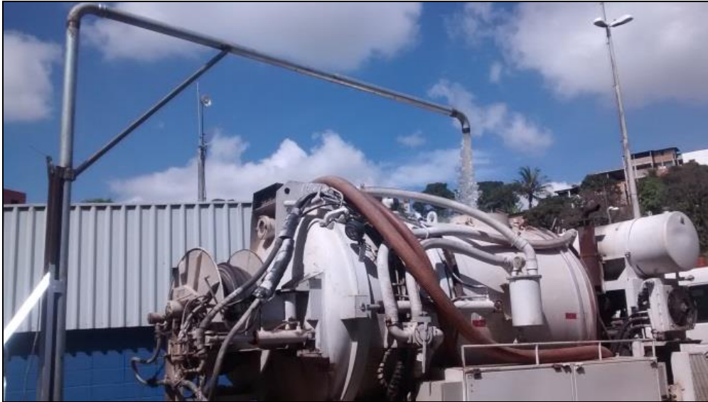
Figura 3. Abastecimento de caminhão com água de reuso na ETE Bandeirantes.
