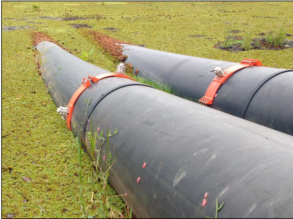
Foto 02 - detalhe das válvulas das abraçadeiras
