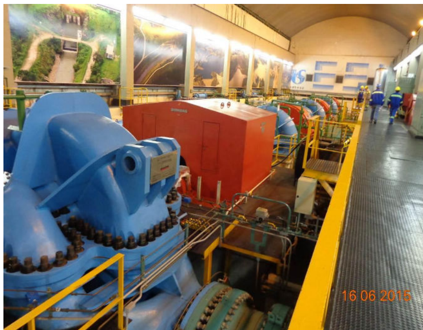
Foto 01 – estação elevatória de Santa Inês – visão geral
