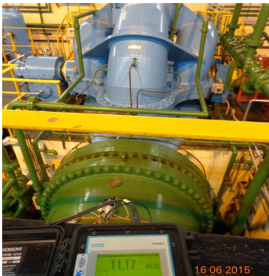
Foto 03 – medidor de vazão instalado no grupo moto bomba n.º 01
