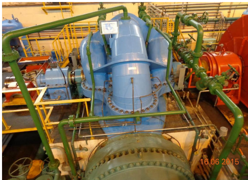
foto 02 – grupo moto bomba n.º 01
