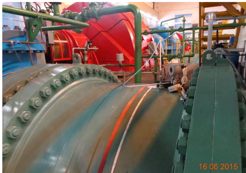
foto 04 – transdutor de pressão instalado na sucção do grupo moto bomba n.º 01
