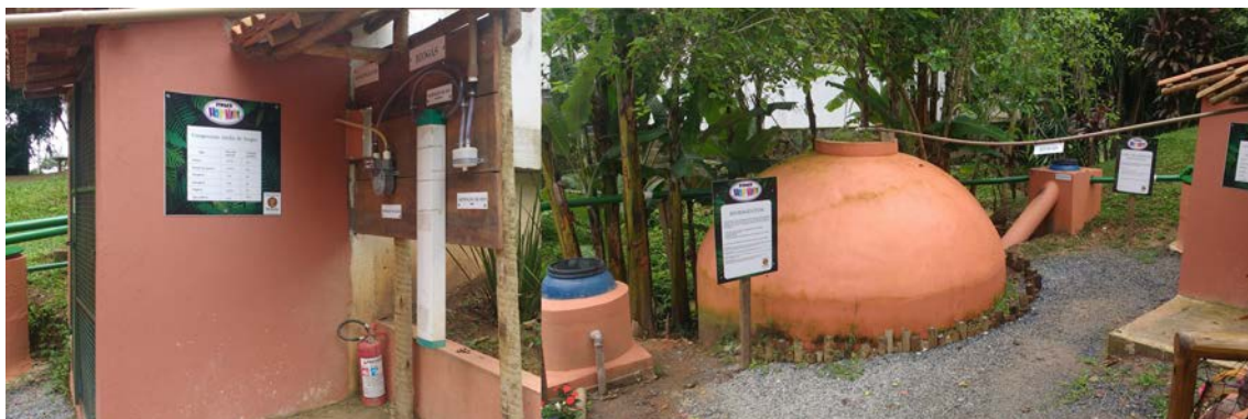
Figura 2: Instalação e funcionamento do biodigestor anaeróbio.
