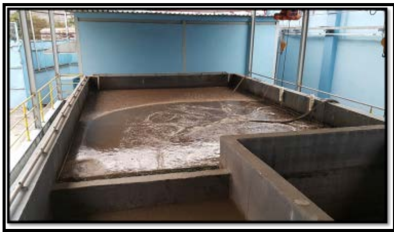
Figura 02 – Tanque de aeração e decantação.
