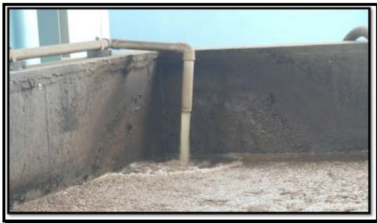
Figura 01 – Afluente sanitário e industrial
