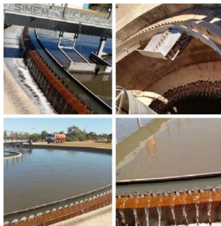
Figura 07: Decantadores da ETE Norte
