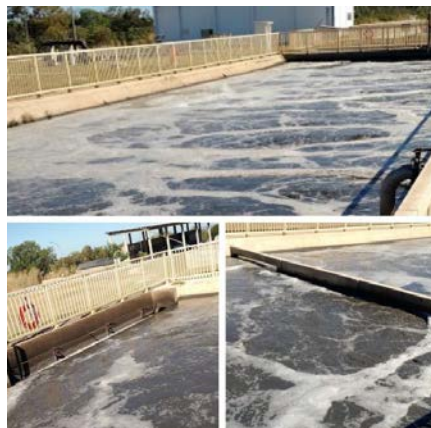
Figura 06: Reatores de lodos ativados da ETE Norte
