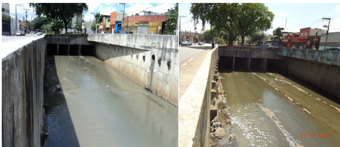
Figura 3 – Córrego Mandaqui poluído (abril de 2011) à esquerda e despoluído (outubro de 2014) à direita.
