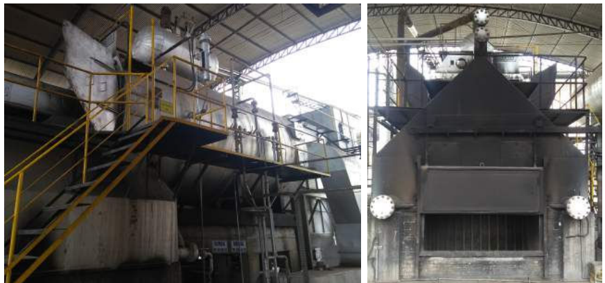
Fotos 1 e 2 – Caldeira Meppan (esq) e fornalha (dir)
