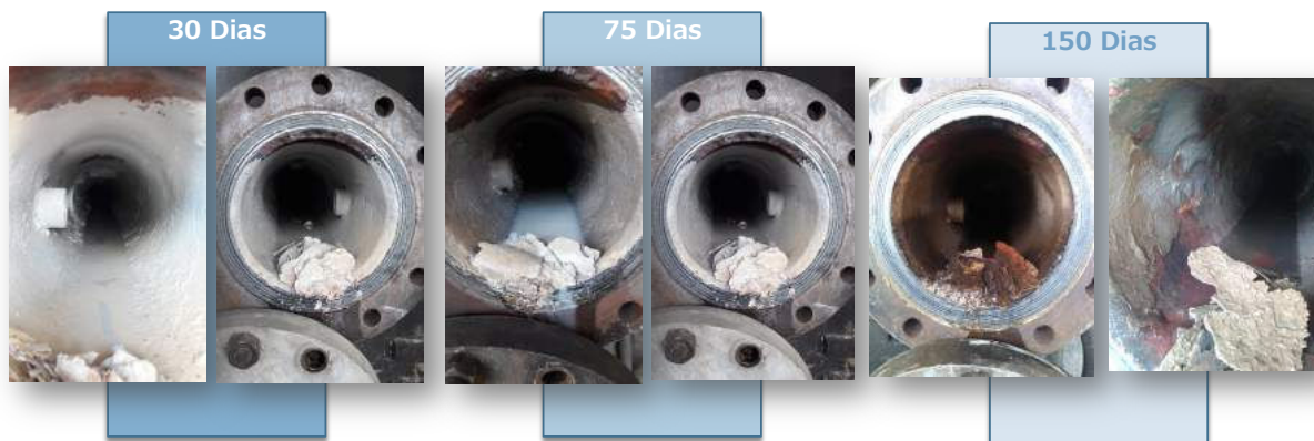
Figura 7 – Evolução da desincrustação nas tubulações de acesso ao topo da fornalha.
