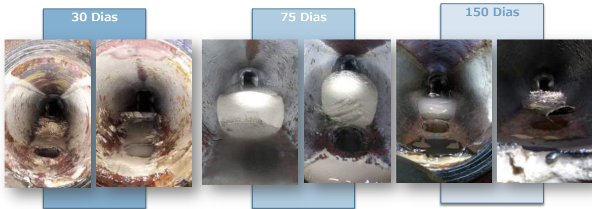
Figura 8 – Evolução da desincrustação na tubulação de descarga da caldeira abaixo da fornalha.
