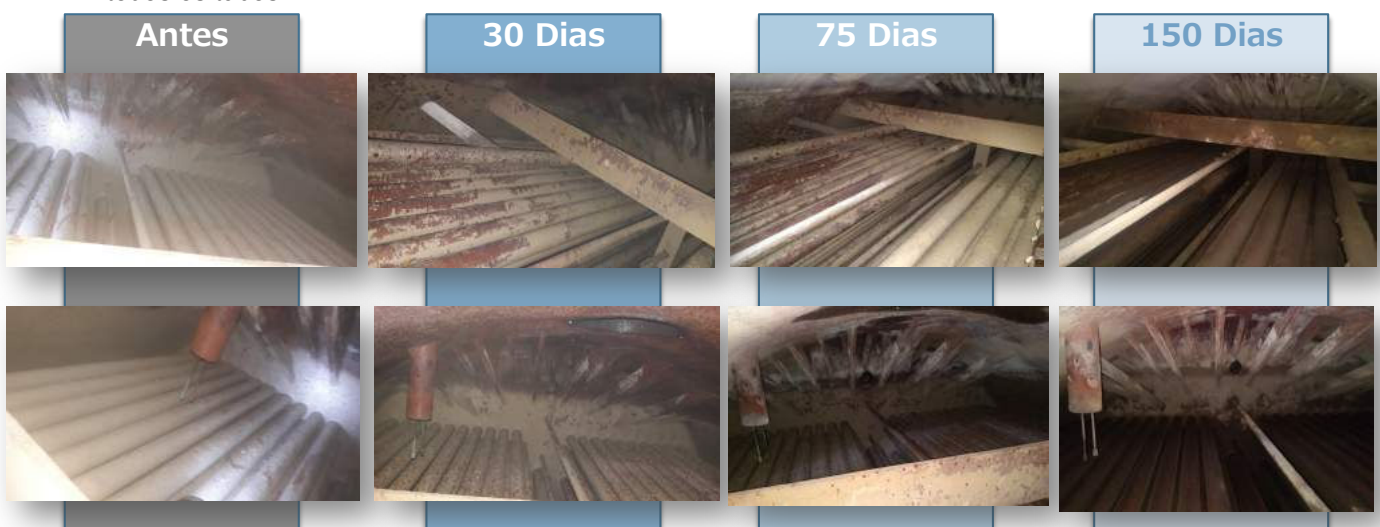
Figura 5 – Fotos com a evolução da desincrustação nos tubos superiores da caldeira.
