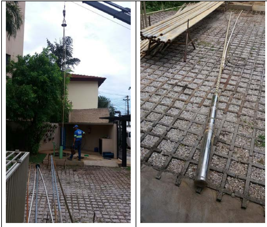
Figura 3: Registro do procedimento de limpeza do poço do condomínio do estudo de caso.
