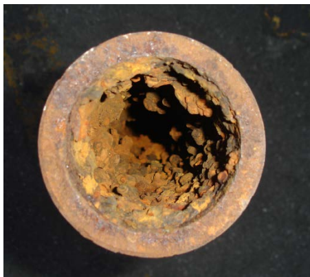
Figura 2: tubulação incrustada. (Fonte: Sabesp/MCEA)
