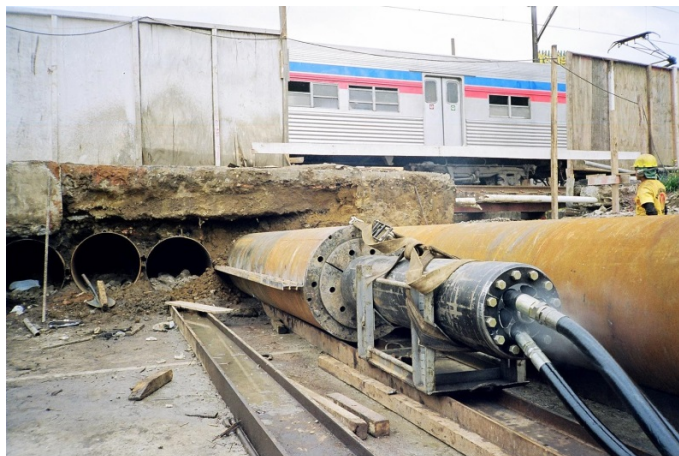
Figura 13: técnica de tubos cravados, alternativa para travessias sob as linhas férreas. (Fonte: Sergio A. Palazzo/ABRATT, Associação Brasileira de Tecnologia não Destrutiva)
