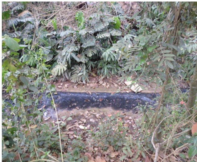
Figura 4: esgoto comprometendo lamina d'água antes
