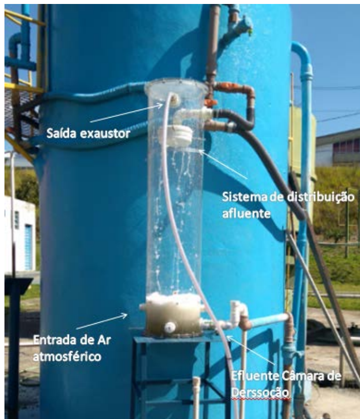
Figura 5 – Vista reator UASB mais Câmara de Dessorção
