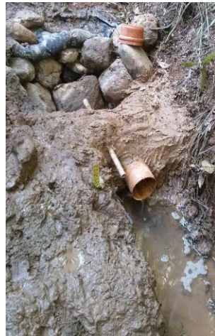
Figura 8: Tubo de captação
