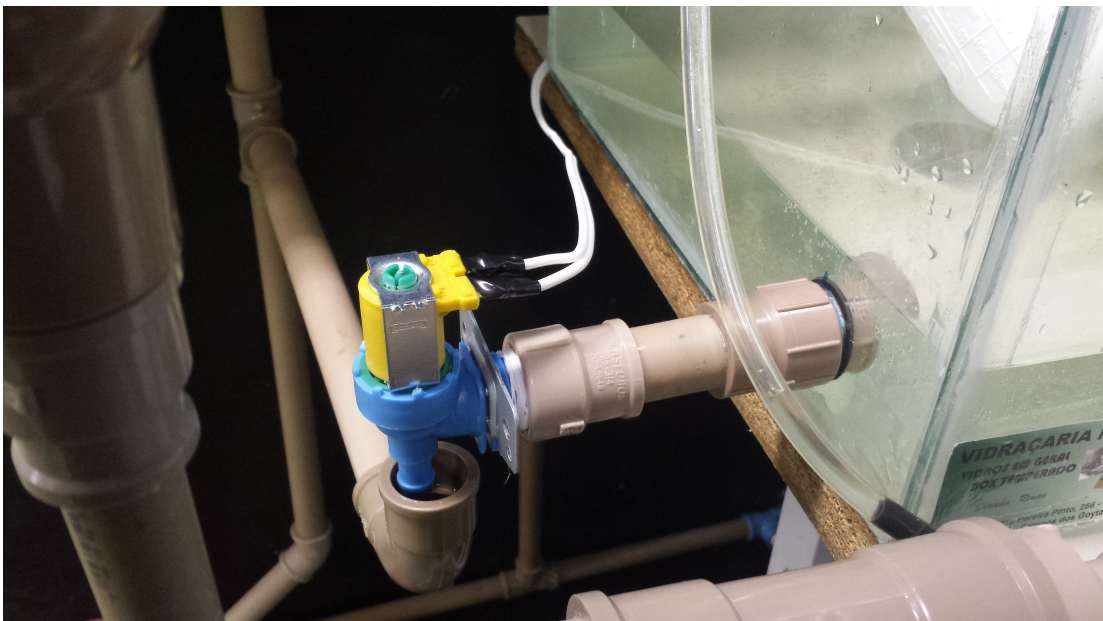
Figura 31 – Válvula solenoide 4 instalada.
