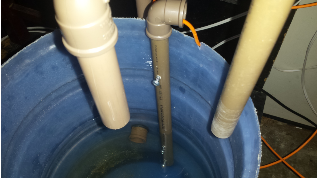
Figura 28 – Chaves de nível baixo e nível alto instaladas.
