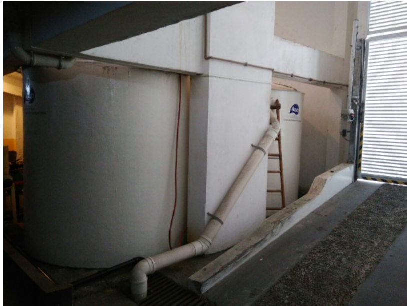
Figura 18 – Planta montada no piso inferior da garagem – ETAC -Edifício Venina, Vila Velha-ES.
