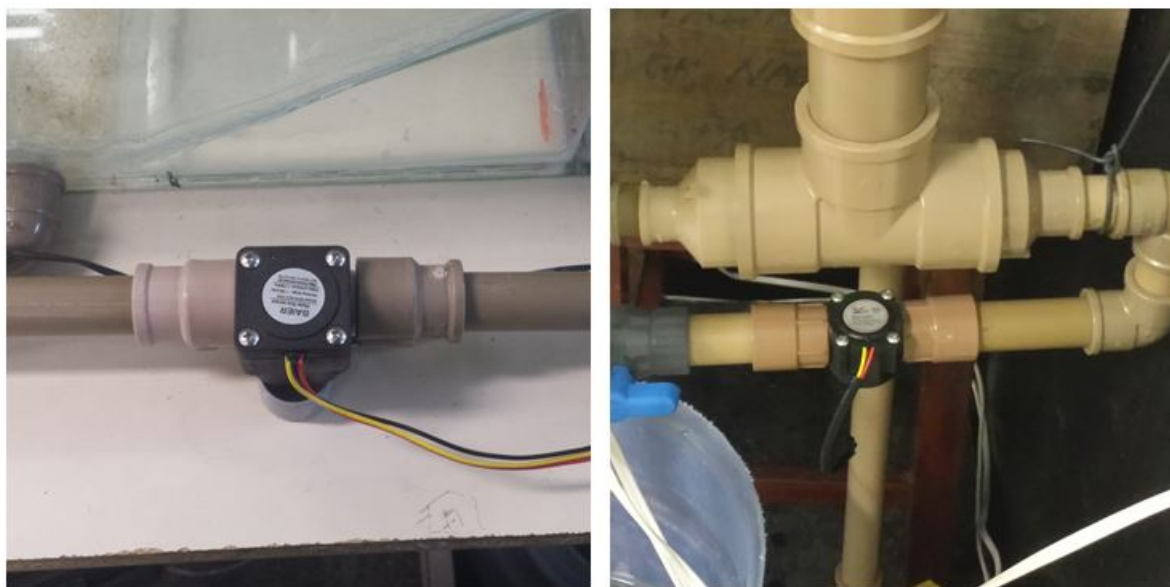
Figura 29 – Sensores de vazão instalados.
