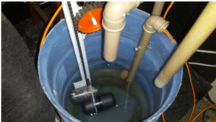
Figura 27 – Sensor de nível instalado.
