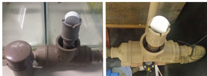
Figura 48 – Fotos dos Dosadores de pastilhas de cloro.
