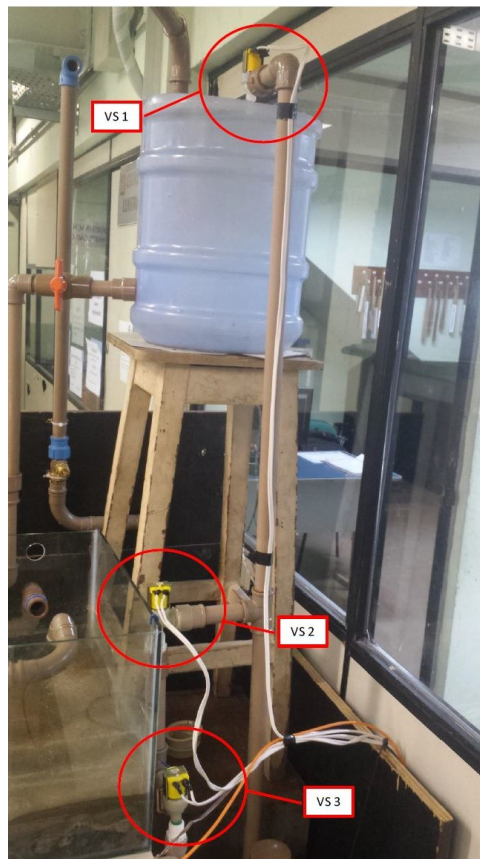
Figura 30 – Válvulas solenoides instaladas.
