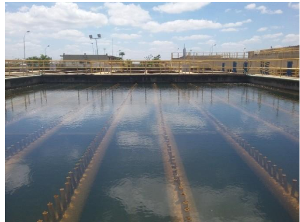
Figura 3 – Decantador da estação de tratamento de Gramame.
