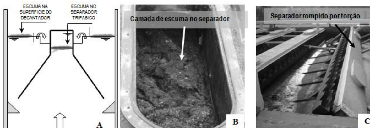
Figura 1 – (a) Regiões de acumulação de espuma em reatores UASB. (b) espuma acumulada no separador trifásico vista de uma escotilha de inspeção; (c) coifa rompida por torção ETE-Piçarrão-SP. Fonte: SANASA
