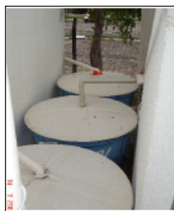
Figura 5 – Reservatório de armazenamento da água da chuva (pré - tratamento)
