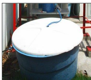
Figura 8 – Reservatório de água filtrada
